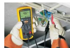
Comprobación del aislamiento en una pequeña caja de distribución: todo en el mismo sitio
